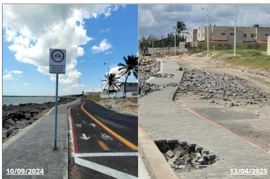
Figura 4 - Trecho do calçadão deteriorado em função das ondas
