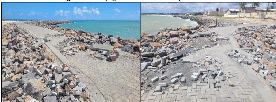
Figura 6 - Espigão nº7 danificado pelas ondas
